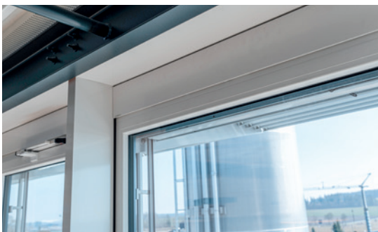
Innenansicht Lüftungseinheit - Blick aus dem Innenraum
