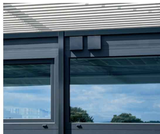
Außenansicht Lüftungseinheit - Blick von der Terrasse
